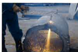
亜鉛引き切断にハネがない
